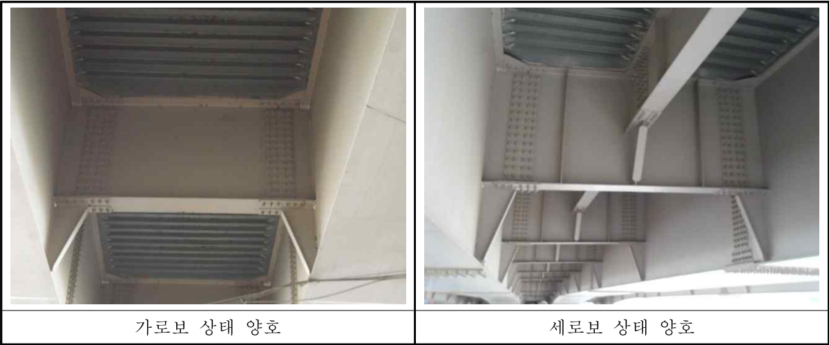
<표 3.6> 범물방향 가로보 외관조사 결과
