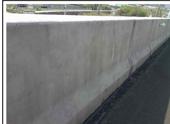
S2 방호벽 균열(폭 0.2mm)
