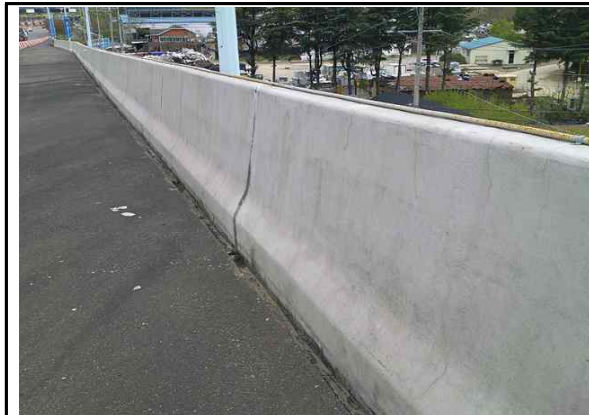
S2 방호벽 균열(폭 0.2mm)
