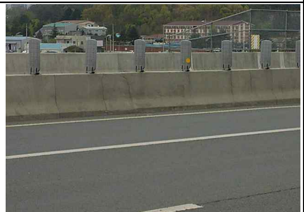
S5 중앙분리대 균열(폭 0.2mm)
