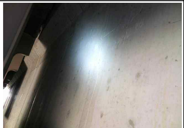
A2 흉벽 균열(폭 0.2mm)
