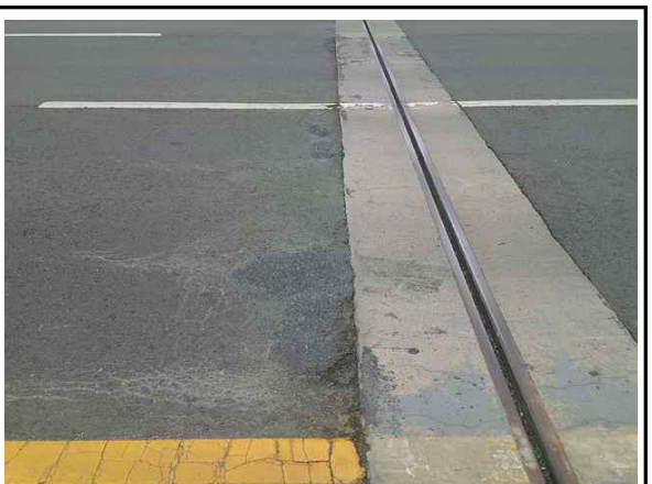
S4(P3) 아스콘 파손
