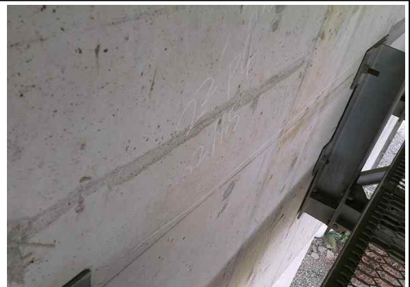
P4 코핑부 균열(폭 0.2mm)
