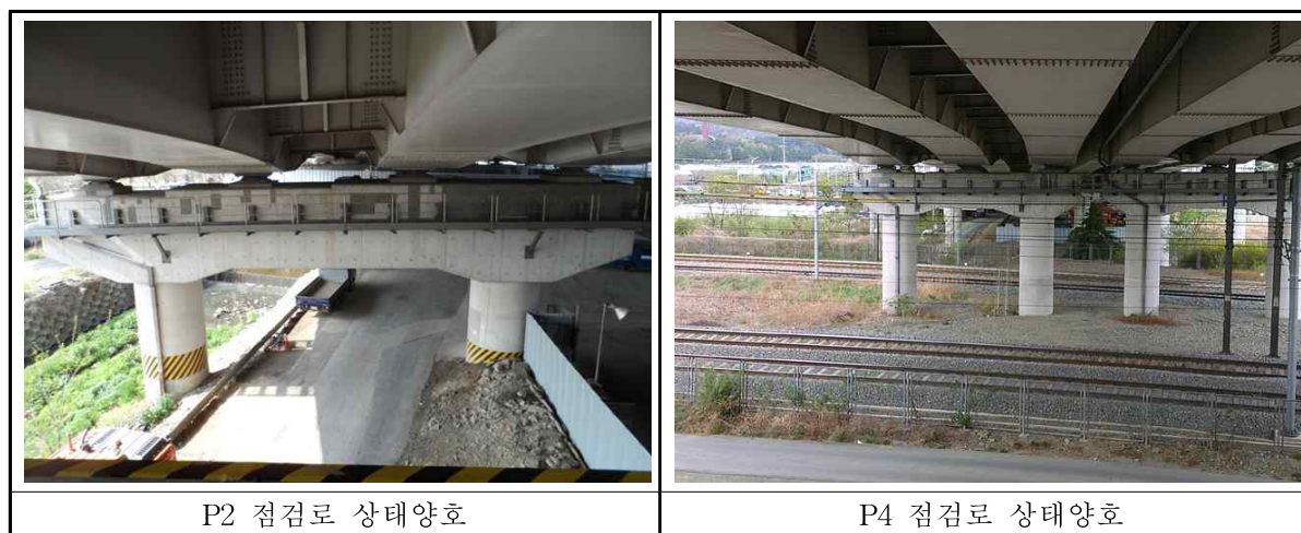
<표 3.58> 안심방향 점검시설 외관조사 결과
