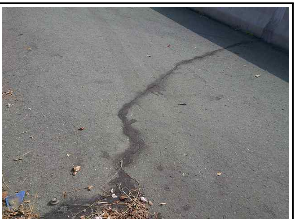
S1 아스콘 균열
