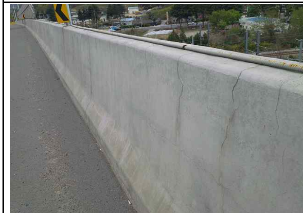
S5 방호벽 균열(폭 0.2mm)
