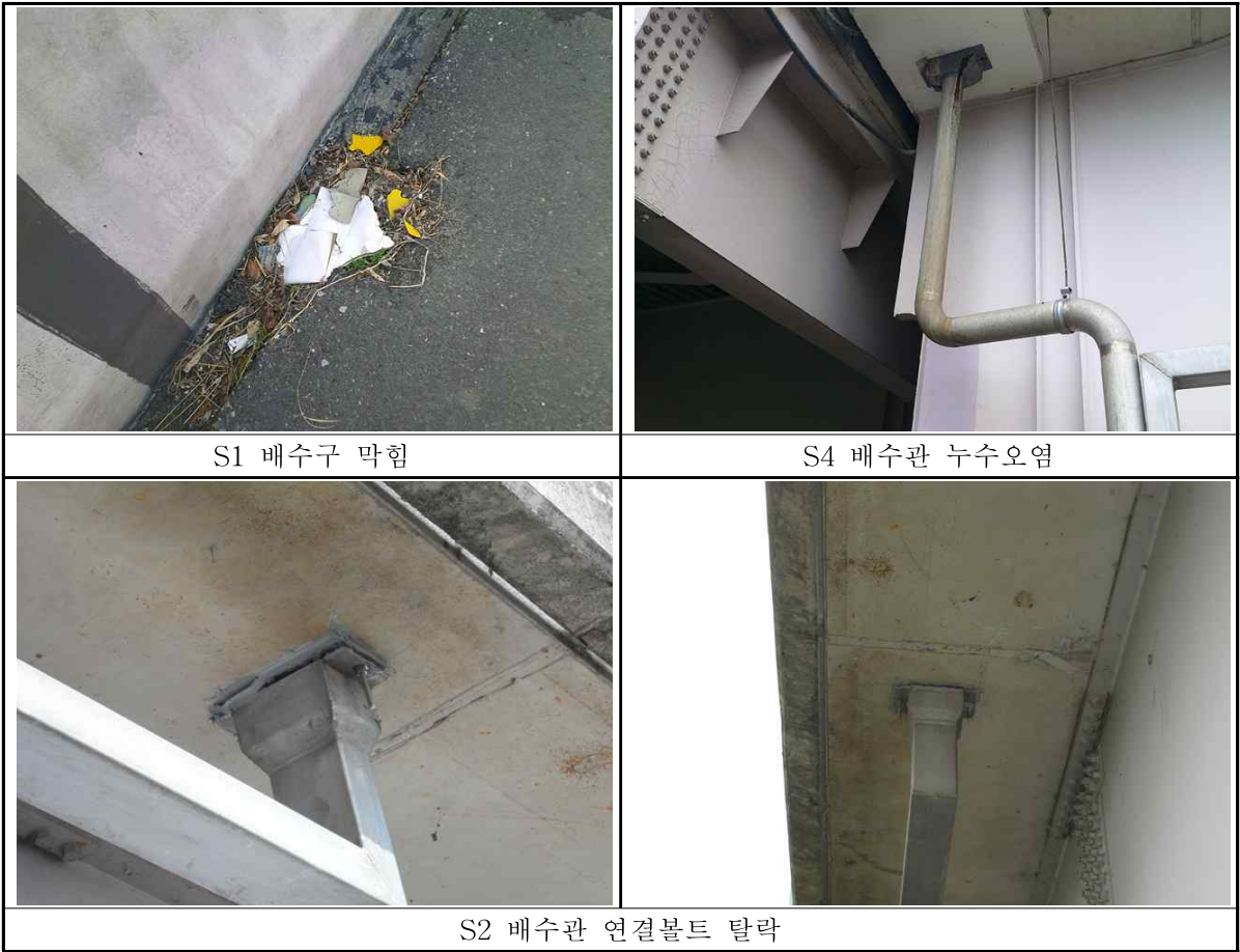
<표 3.54> 안심방향 배수시설 외관조사 결과
