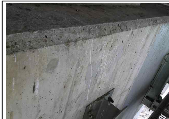
P3 코핑부 균열(폭 0.2mm)
