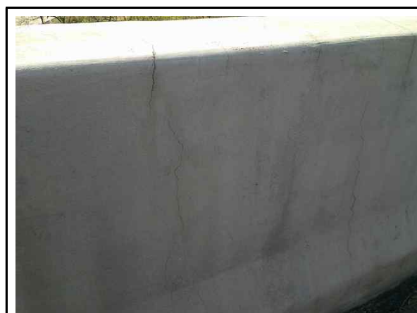
S1 방호벽 균열(폭 0.2mm)
