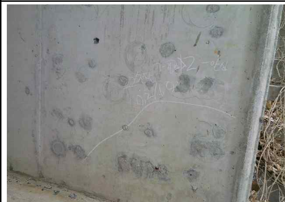
A2 흉벽 균열(폭 0.2mm)
