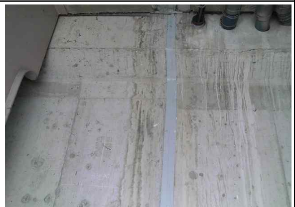
A2 실란트 보수 - 양호
