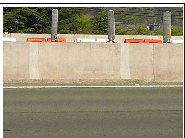
S1 중앙분리대 균열(폭 0.1mm)
