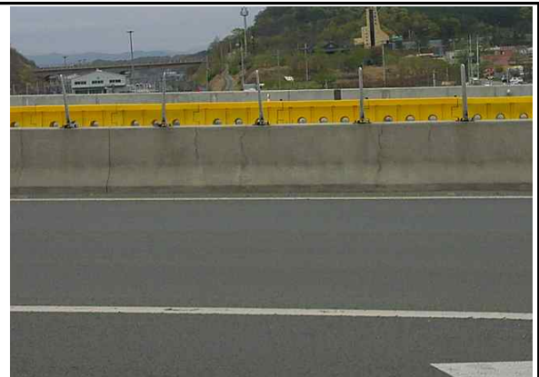
S2 중앙분리대 균열(폭 0.2mm)
