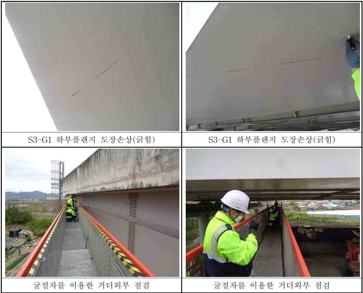
<표 3.2> 범물방향 거더 외부 외관조사 결과
